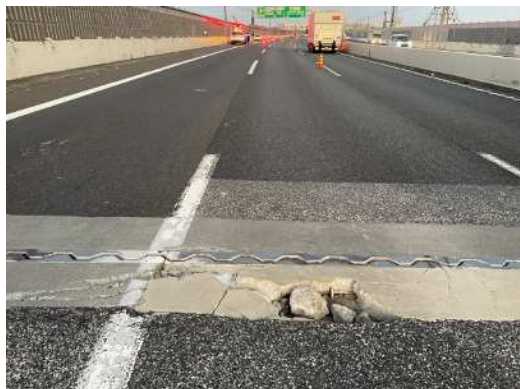
路面損傷状況
