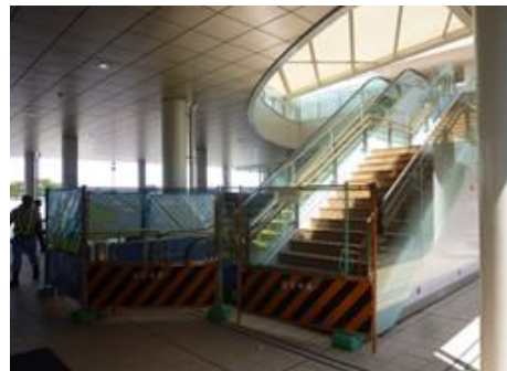
下り線 展望デッキへの階段等の閉鎖
