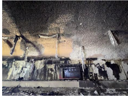
火災後のコンクリート表面
