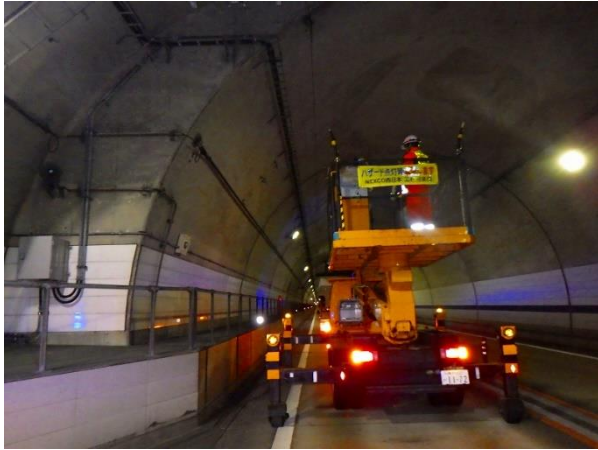
〈設備点検 状況〉
