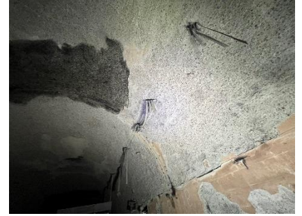
トンネル側面の剥離
