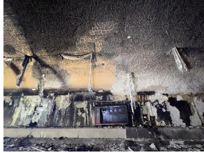
火災後のコンクリート表面
