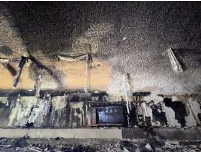
火災後のコンクリート表面
