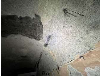
トンネル側面の剥離
