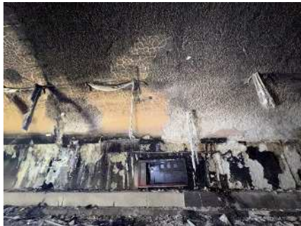
火災後のコンクリート表面
