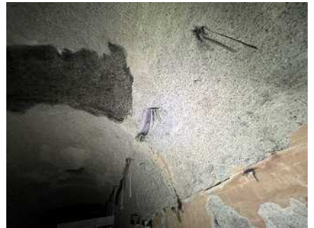
トンネル側面の剥離
