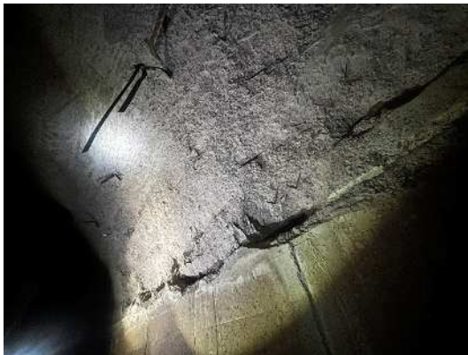
トンネル側面のコンクリートの剥離
