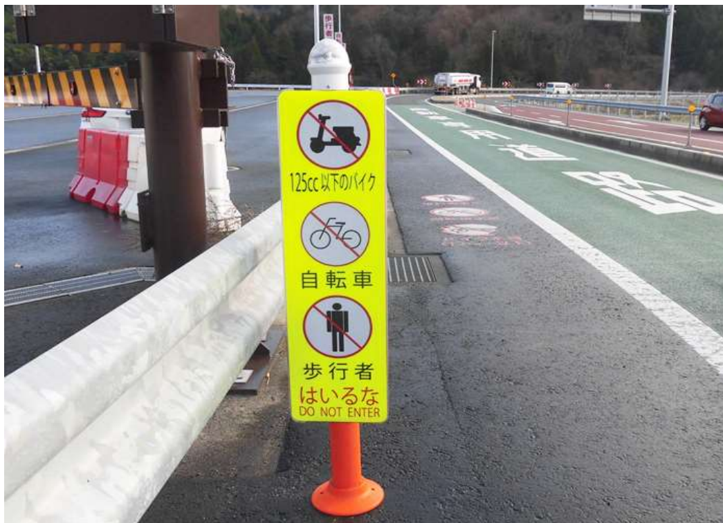
誤進入防止対策
