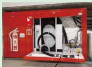
消火ノズル レバー
