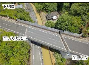
九州道 片野川橋(復旧前)
