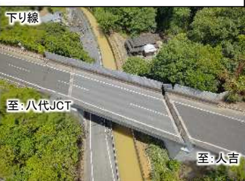
九州道 片野川橋(復旧前)
