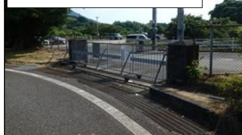
宮原 SA(上り線)緊急開口部
