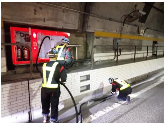
<トンネル非常用設備点検>
