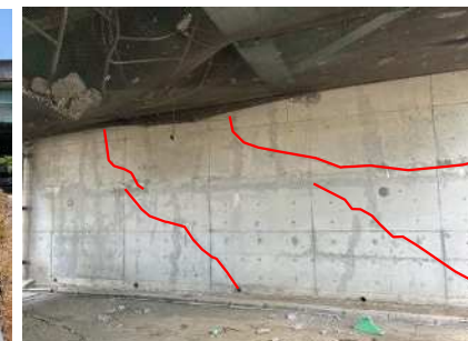
橋台前面にクラック
