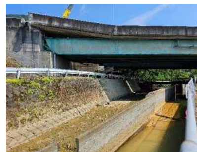
A1: 床版のめくれあがり
