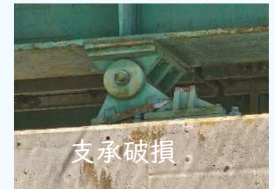
橋台に橋桁衝突
