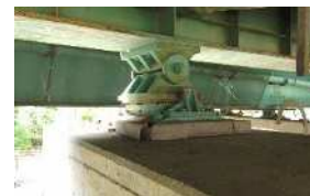
P1: ピンローラー支承破損 A1側に変位
