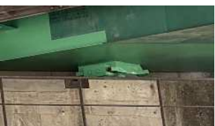
A2: 上沓を中心に損傷
