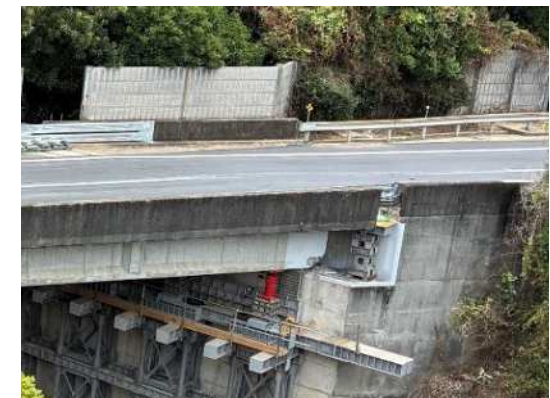
応急復旧(一般車両通行可能)
