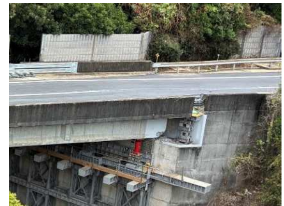
応急復旧(一般車両通行可能)
