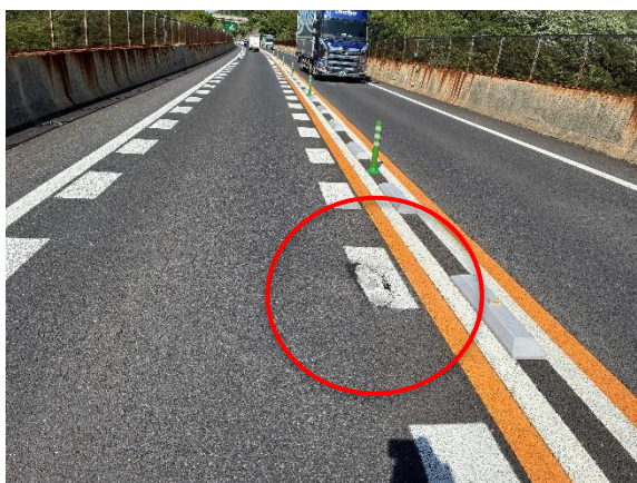
《補修箇所② 施工前》
