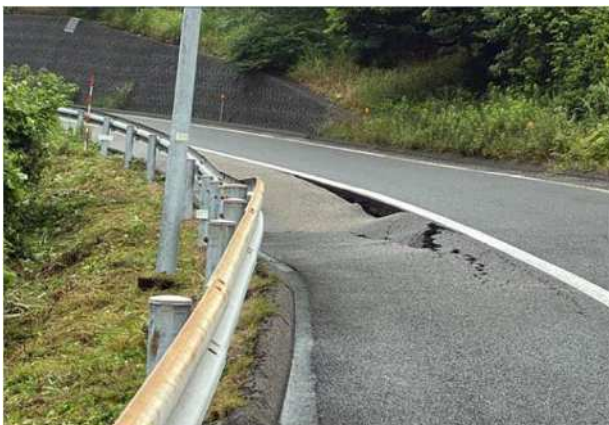
路肩部に変状
