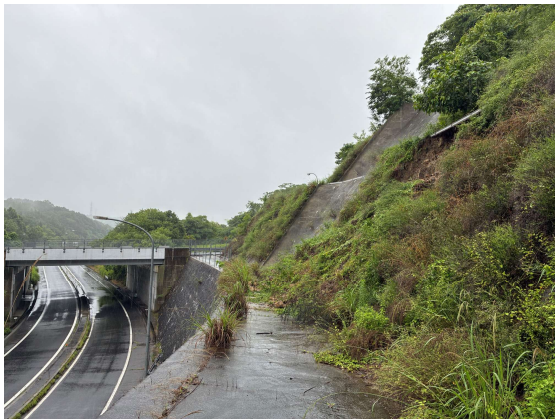
(切土のり面崩落の状況①)
