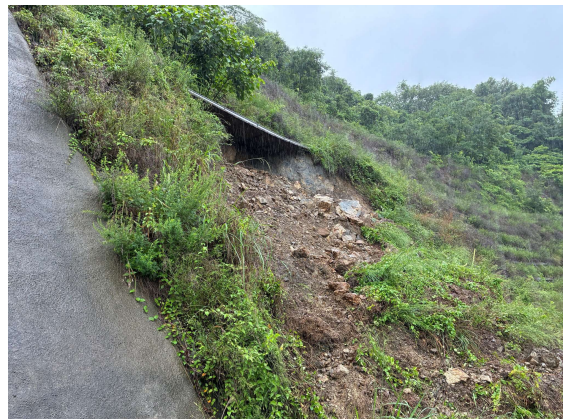
(切土のり面崩落の状況②)
