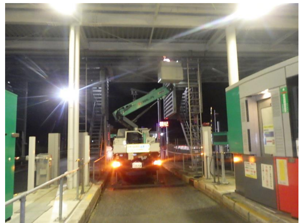
<ETC 設備工事>
