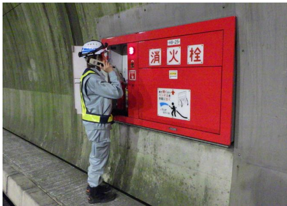
＜トンネル非常用設備点検＞
