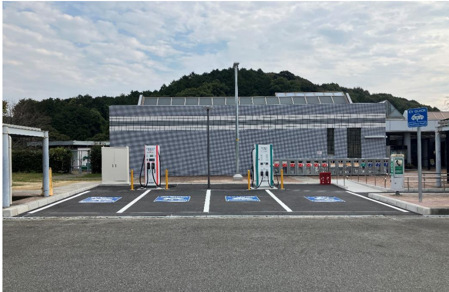
急速充電設備 (E3 九州自動車道 基山 PA 下り線)
