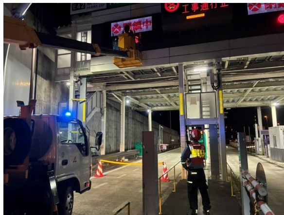
《ETC 設備点検状況》
