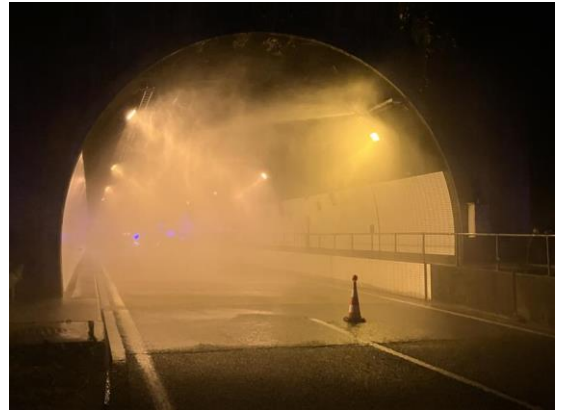
＜延焼防止設備放水試験＞
