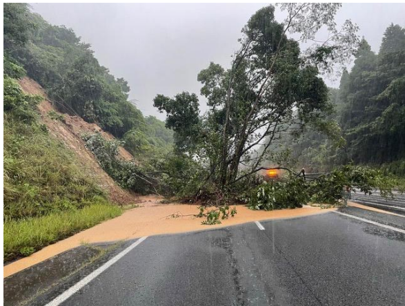
(のり面崩落・倒木の状況)
