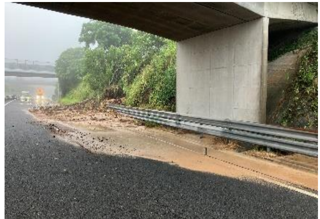
(のり面崩落の状況)
