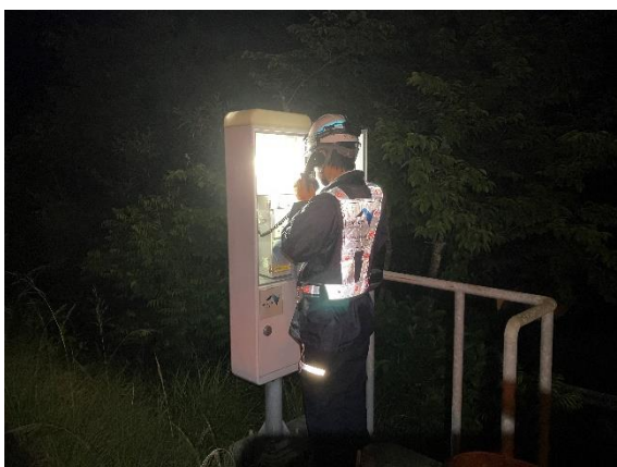
< 非常用電話設備点検 >
