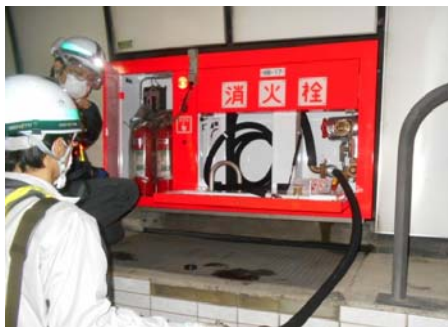
【非常用設備点検】
