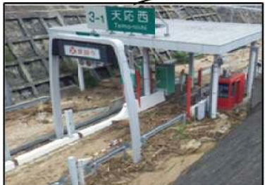
・土砂流入による料金所閉塞
