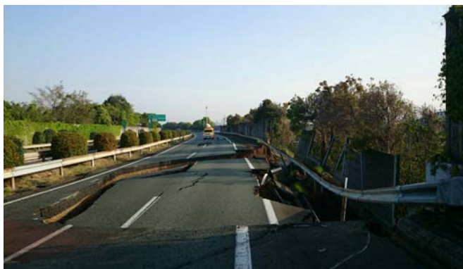
■九州自動車道（益城熊本空港 IC～御船 IC） 177.8kp 付近 土工部盛土法面・路面の被害状況
