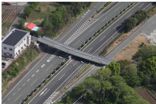
■九州自動車道 緑川 PA(御船 IC～松橋 IC) 跨道橋(県道 32 号小川嘉島線 府領第一橋)の被害状況
