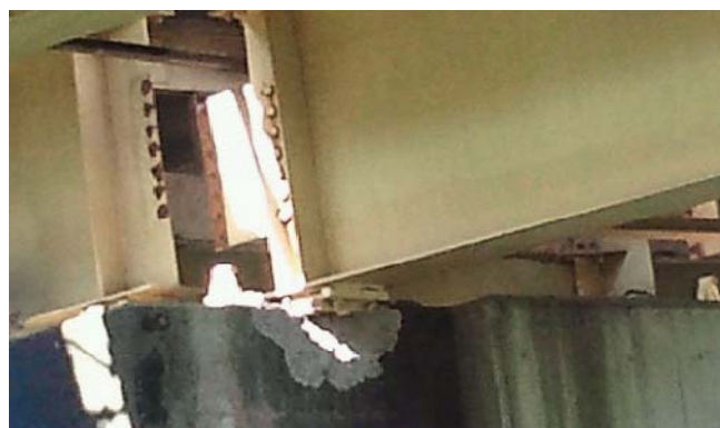
■九州自動車道（益城熊本空港 IC～嘉島 JCT） 179.6kp 付近 木山川橋の被害状況
