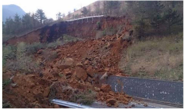
大分自動車道(湯布院 IC～日出 JCT) 93.7kp 付近 のり面土砂崩落状況(※現在排土作業中)
