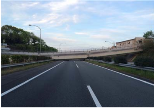
九州自動車道 緑川 PA186.9kp 付近 跨道橋(府領橋)の被害状況
