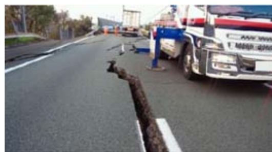
土工部縦断方向ひび割れ(下り線)177.8KP (益城熊本空港 IC～嘉島 JCT 間)
